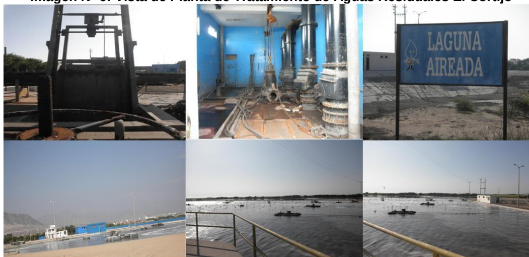
Imagen N° 6: Vista de Planta de Tratamiento de Aguas Residuales El Cortijo
