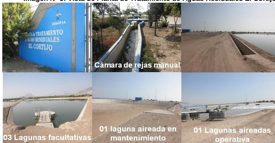
Imagen N° 5: Vista de Planta de Tratamiento de Aguas Residuales El Cortijo
